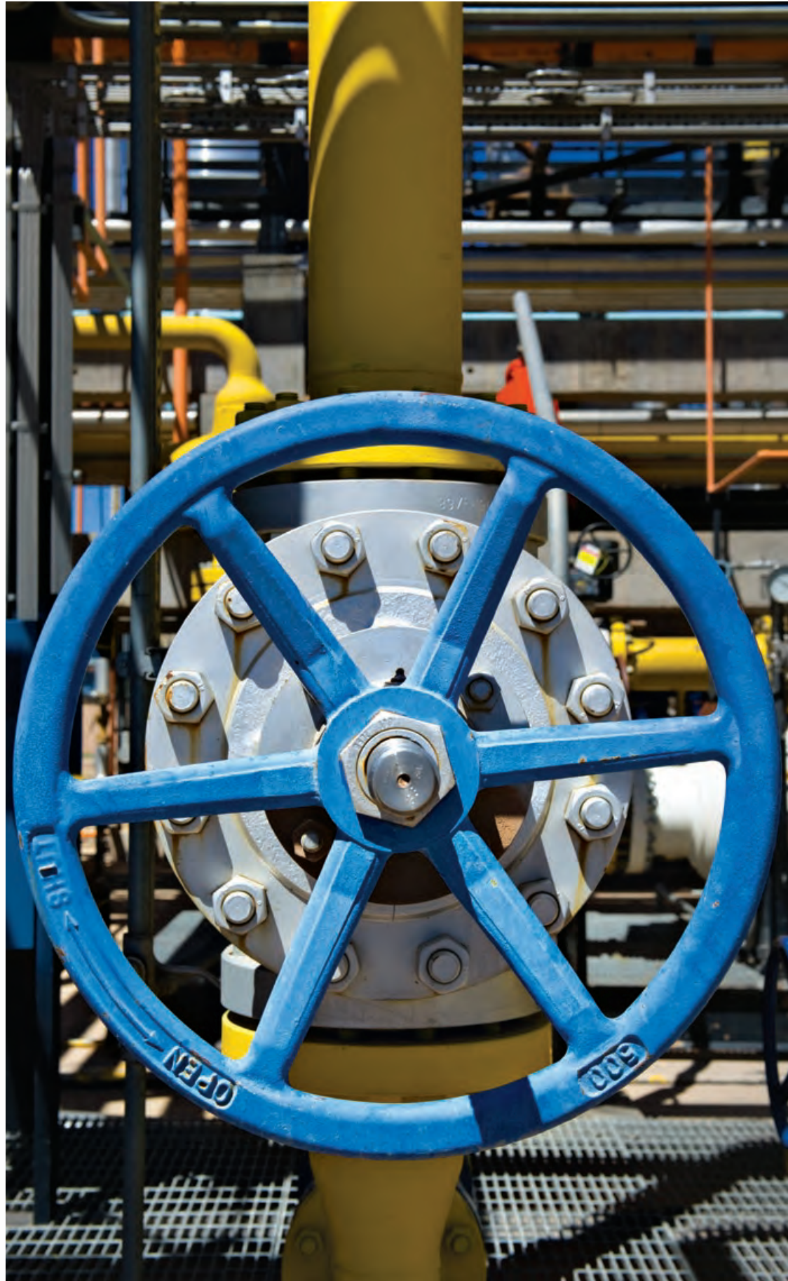
» Detalle de Válvula Azul en Planta GLP. (El Portón, Neuquén)
