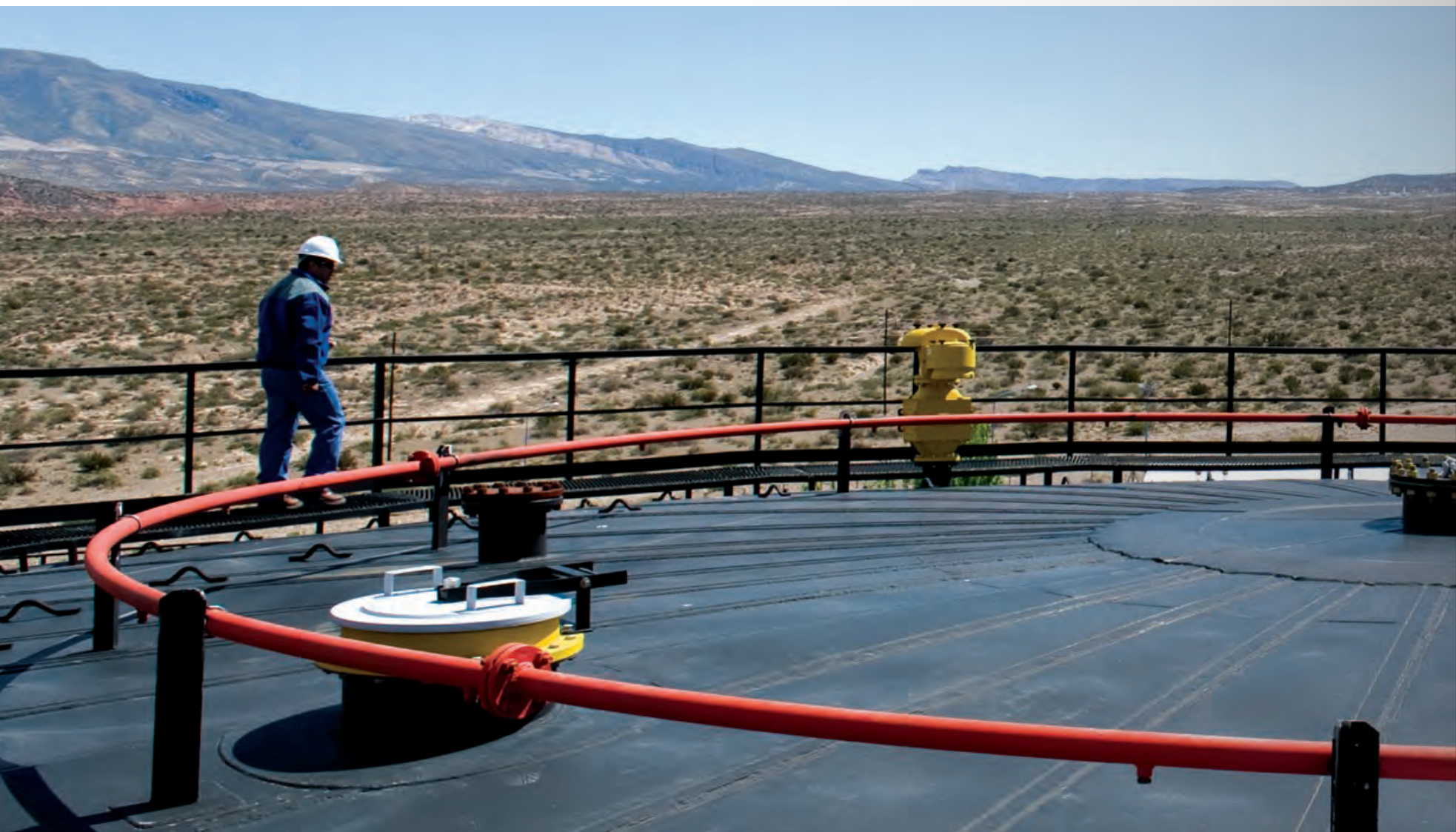
» Tanque de despacho de crudo de 200 mil m 3 de capacidad en la Planta de Tratamiento de Crudo. (El Portón, Neuquén)
