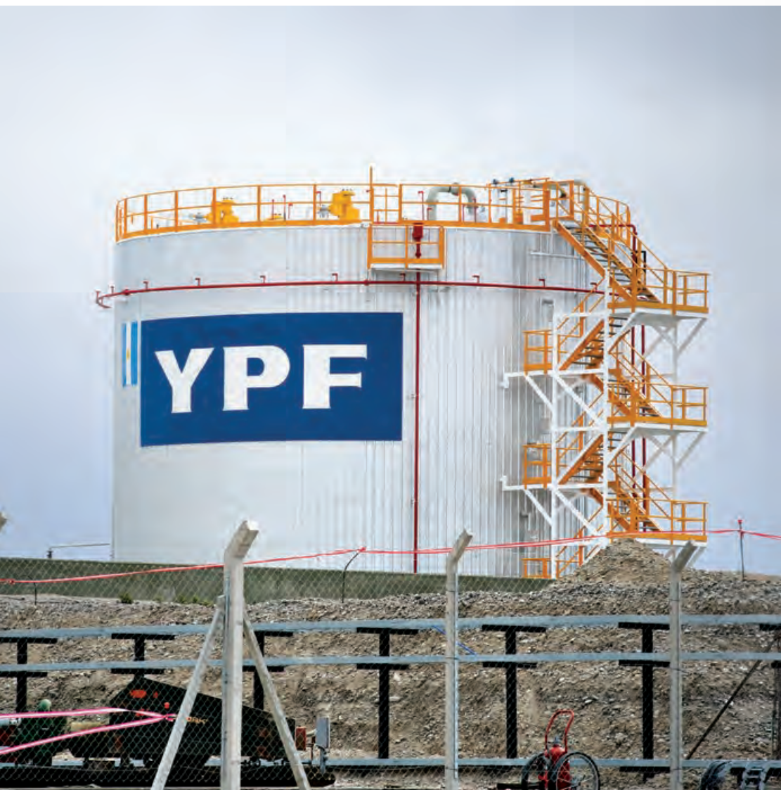
« Tanques de almacenaje en Manantiales Behr. (Chubut)
